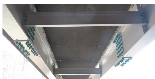
板橋国道橋(ボルト落下防止キャップ)
